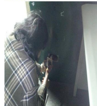
開關已壞-維修中
